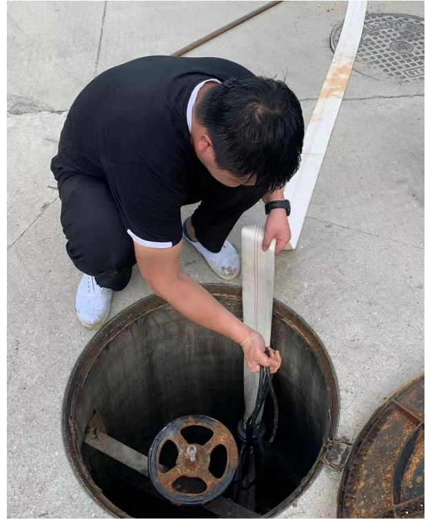
雨水闸阀口放置抽水泵
